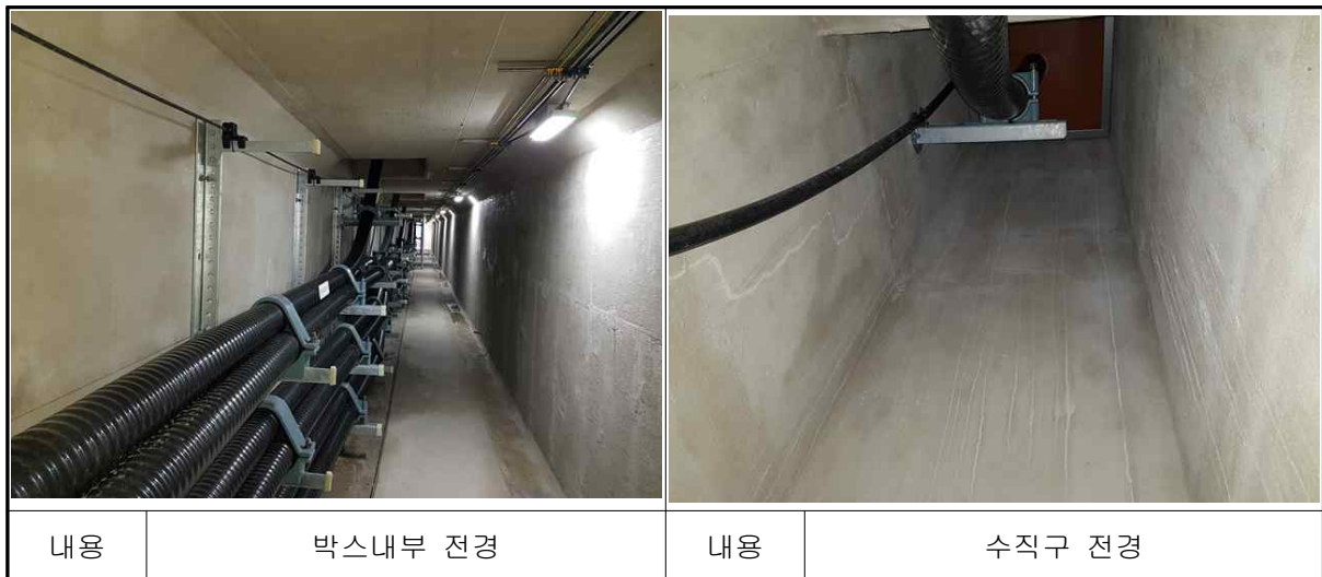
【사진 2.1】 포천인출 전력구 현황
